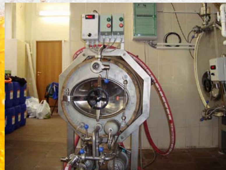
Стилизованная установка для СИП-мойки емкостей, работающая в ресторане «Балтика Брю»
